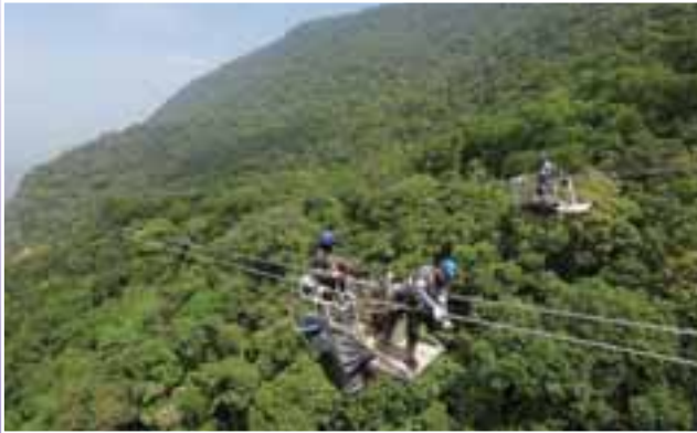
Mejora de Capacidad Línea Transmisión (345 kV). Baixada Santista-Tijuco Preto, Brasil.
