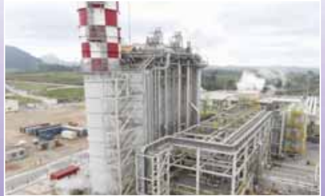
Planta térmica de generación de electricidad mediante ciclo combinado. Brasil. Potencia total instalada, 565 MW.
